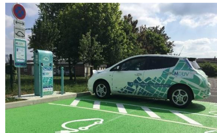
Borne de recharge électrique (SE60)
